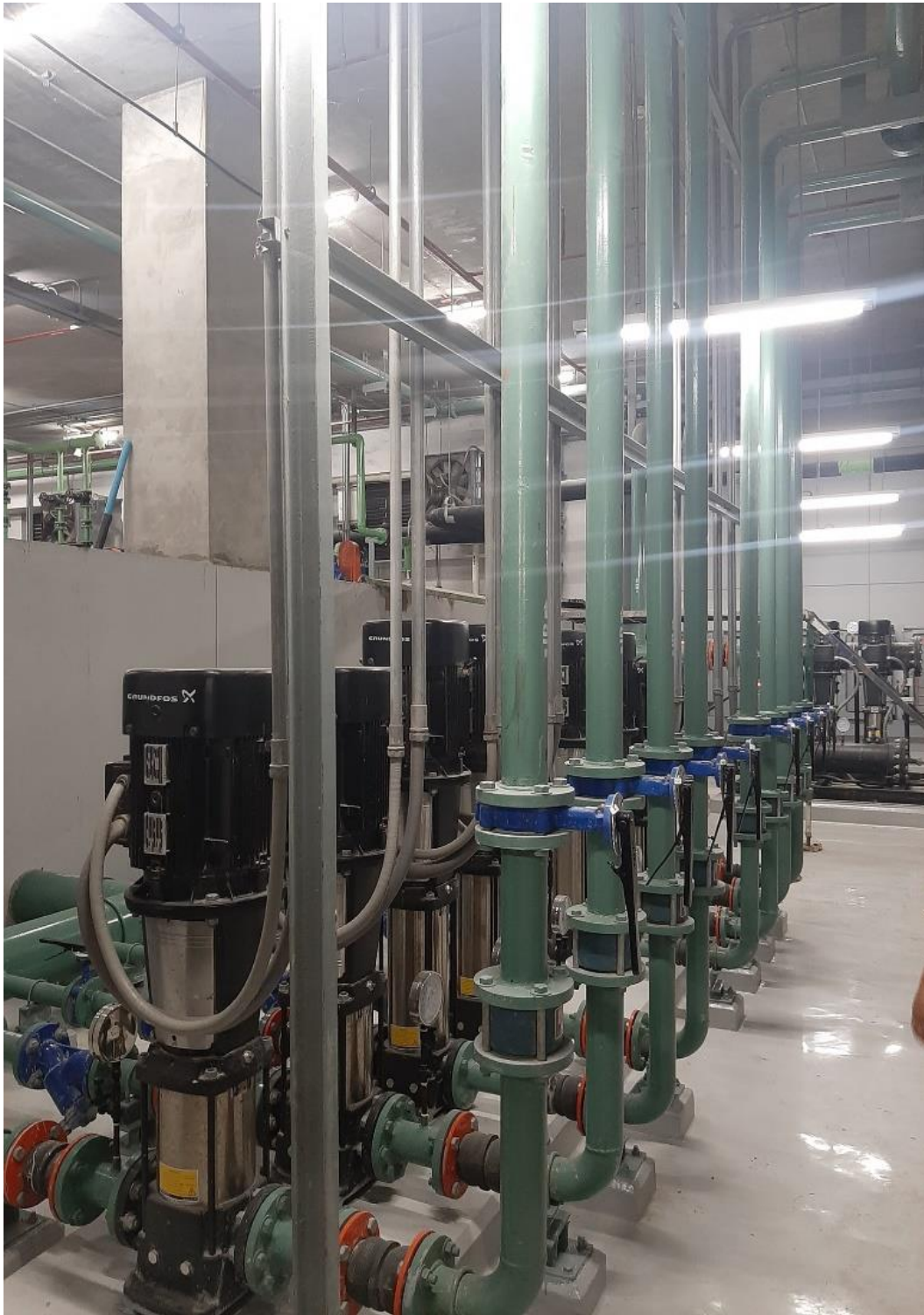
ภาพระบบบำบัดน้ำเสีย
